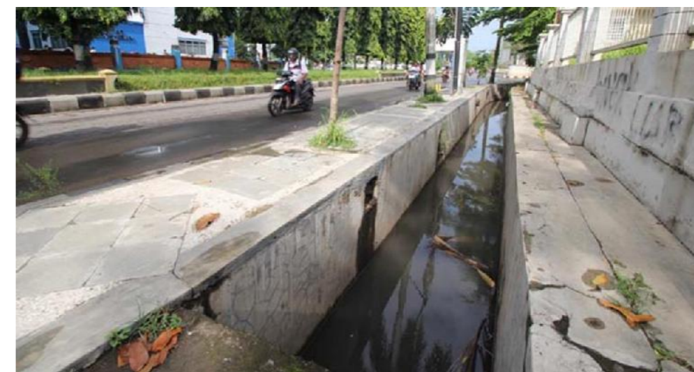
Gambar 4.2 Kondisi Drainase di Kota Cirebon
